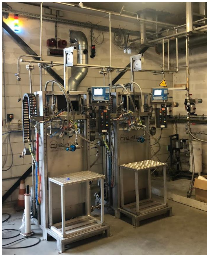
Figure 10 : exemple d'installation de conditionnement de GLI
